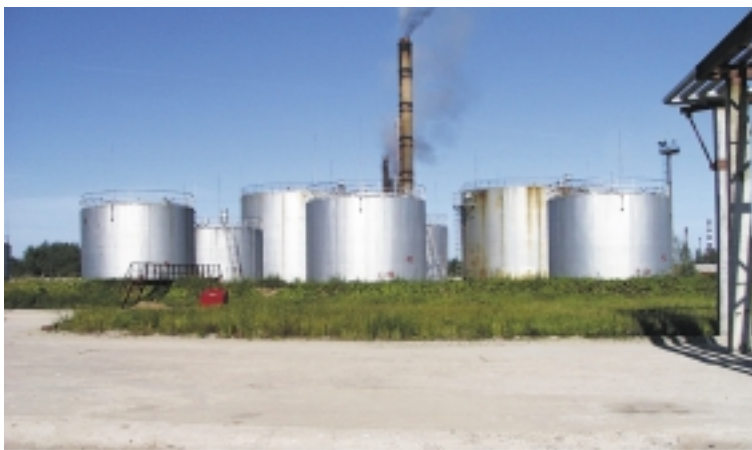
Резервуары топлива на нефтебазе КИНЕФ
