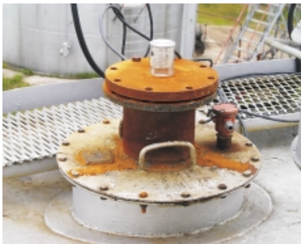
Рис. 5. Размещение уровнемера TS-01 на крыше резервуара
