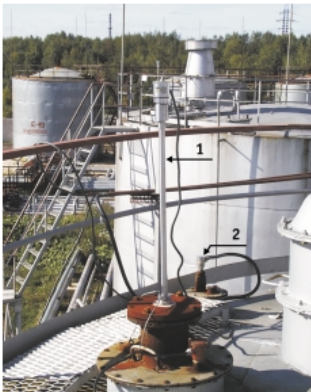
Рис. 6. Размещение уровнемера TS-02 (1) и сигнализатора ASL-400 (2) на крыше резервуара
