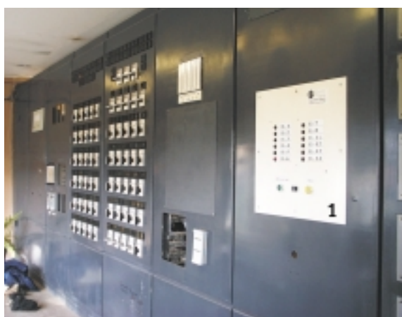
Рис. 10. Панель индикации (1) системы аварийной сигнализации
