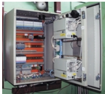
Рис. 3. Технологическая станция, обслуживающая 20 резервуаров парка
