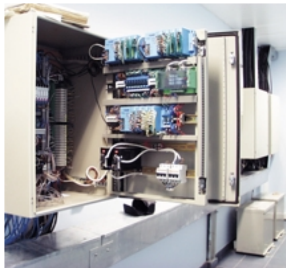
Рис. 7. Один из шкафов АСУ ТП ПСТ-2
